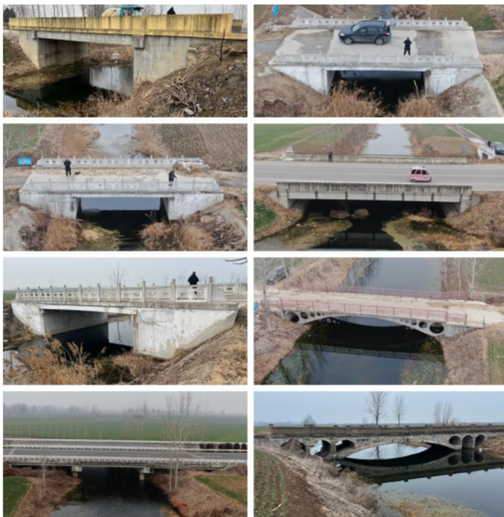
图 3-5 常沟百善镇段桥梁建筑物现状
